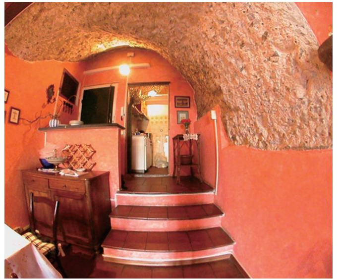
写真6 住宅内部に残るローマン・コンクリート造のヴォールト
