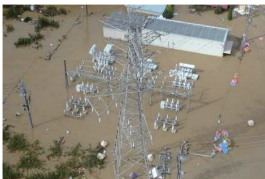
冠水した送電設備（長野市豊野町：中部電力の情報から）
