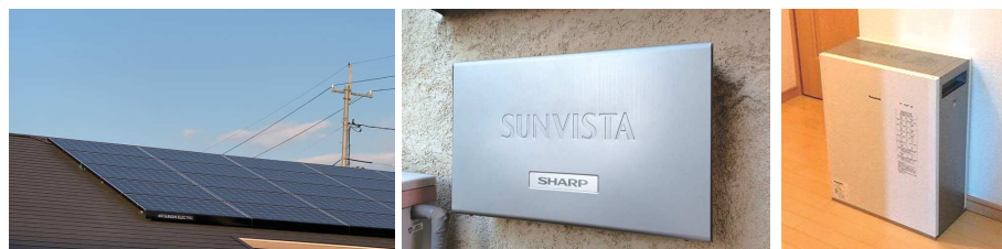
太陽光パネル
