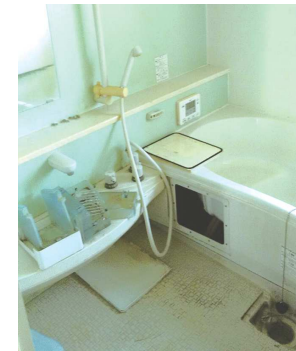
浸水したユニットバス
