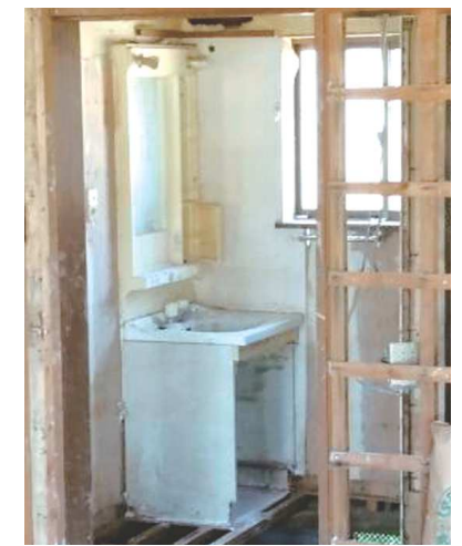
浸水後の洗面台
