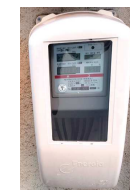
電気メーター
