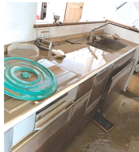
浸水したシステムキッチン
